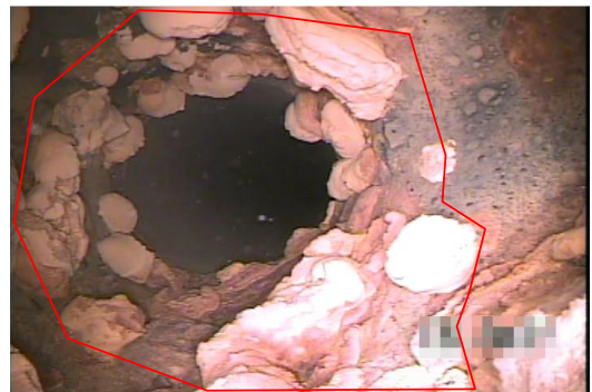
●図表 1-2-11 異形管内面の錆こぶ
