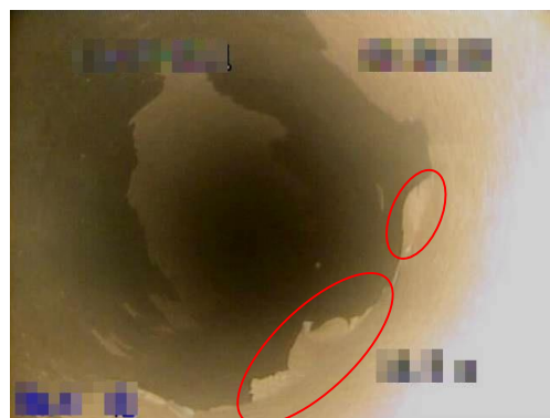
呼び径 75 昭和 57 年布設
