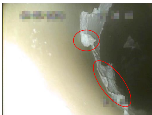
呼び径 300 昭和 50 年布設
