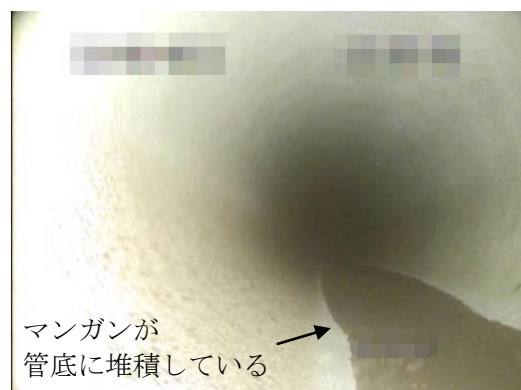
呼び径 100 昭和 59 年布設
