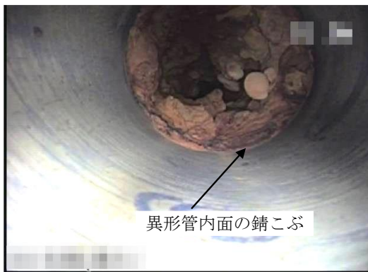
錆こぶなどの状況確認
